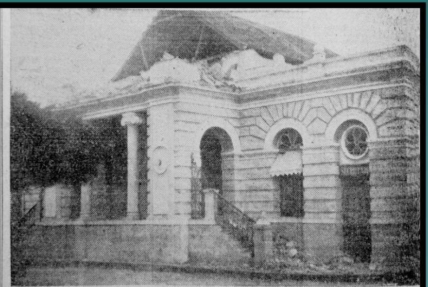
Estado en que ha quedado después de la conmoción sísmica la Casa Consistorial de Moca.
