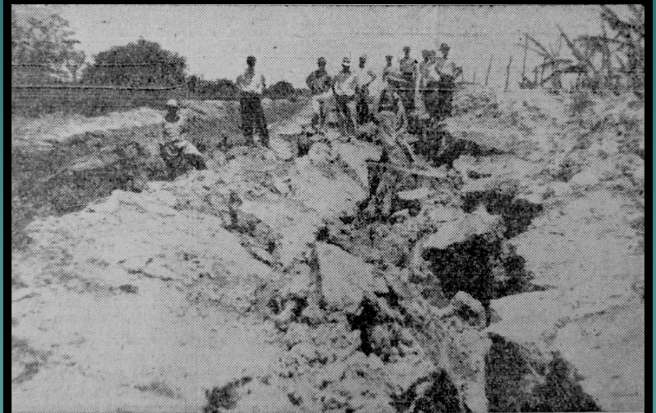
Sector entre Atillo y Platanal, del canal Presidente Trujillo, intensamente afectado por el terremoto
